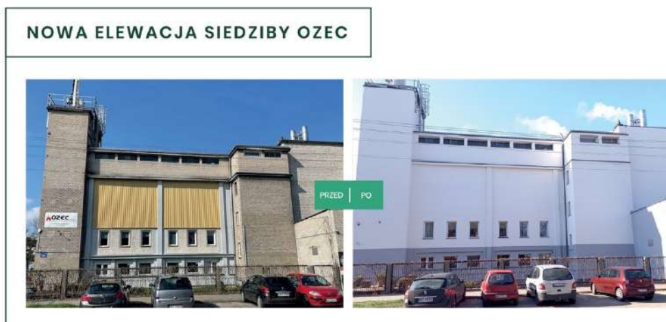
Fot. Siedziba OZEC Sp. z o.o. po dociepleniu i z nową elewacją
